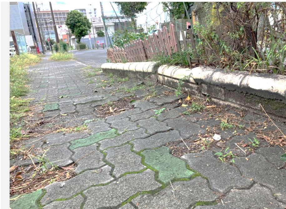
街路樹によって歩道の舗装が持ち上がってしまっている例
